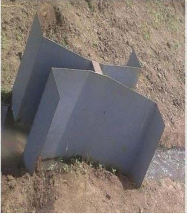
Figure5 Par shall flume
