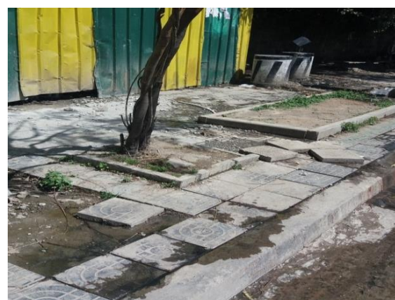
(d) Improper finishing of pedestrian crosswalk
